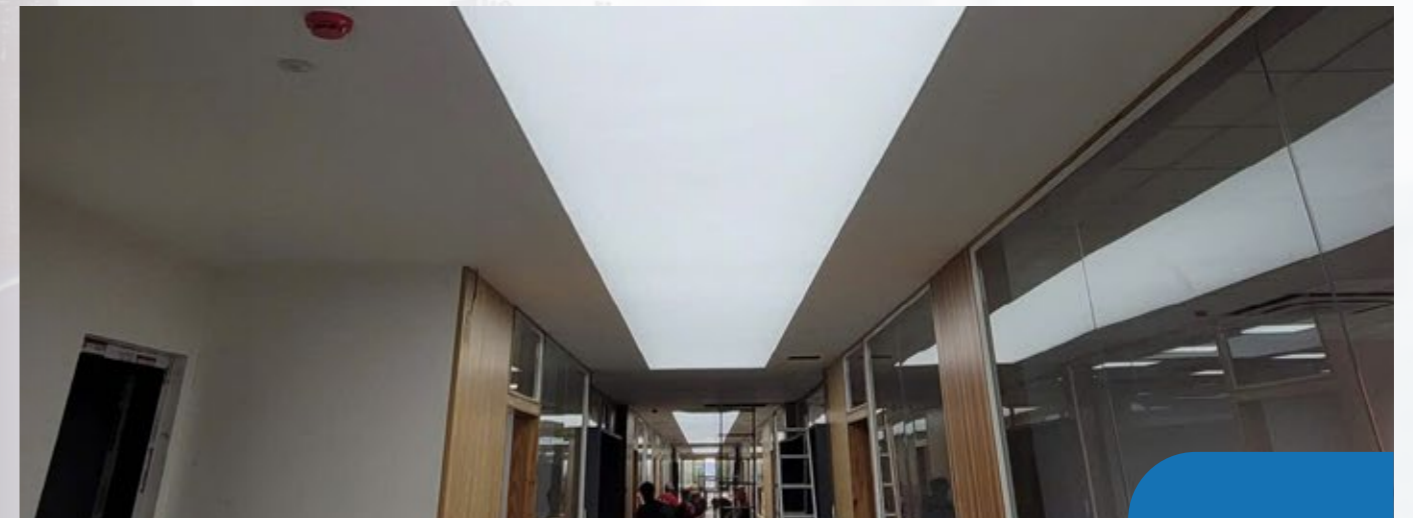
Dự án trần xuyên sáng tại trường Đại Học Công Nghệ - Đồng Nai Stretch Ceiling Project at University of Technology - Dong Nai
